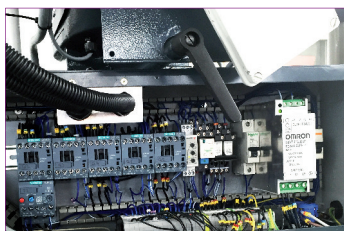
Quadro elétrico DC organizado
